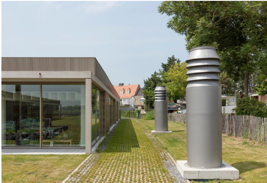
Obr. 19 Vstupné y výstupné hlavice systému núteného vetrania so zemným vzduchovým výmenníkom tepla
