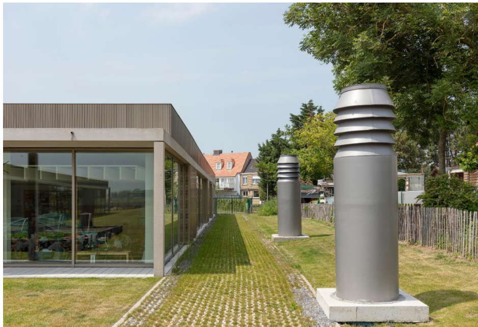
Obr. 19 Vstupné y výstupné hlavice systému núteného vetrania so zemným vzduchovým výmenníkom tepla
